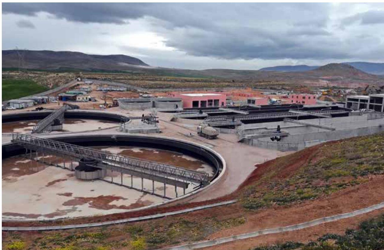
ONA - CONSTRUCTION ET EXPLOITATION DE LA STEP D'ALI MENDJELI Constantine - Algérie
