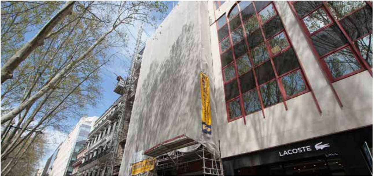
EDIFICIO LIBERDADE 40 Lisboa Portugal
