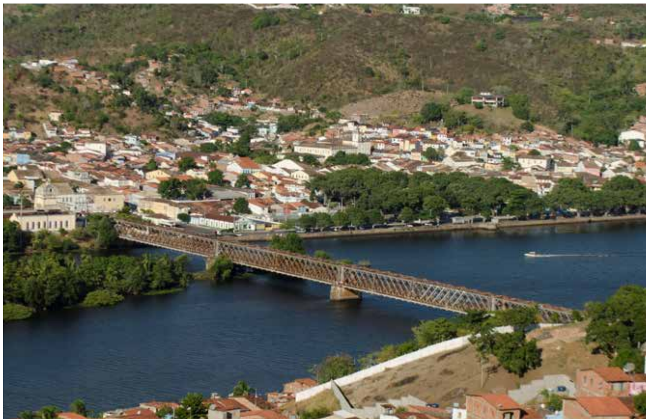
FERROVIA CENTRO ATLÂNTICO - REFORÇO ESTRUTURAL E RECUPERAÇÃO DE ANOMALIAS DA PONTE D. PEDRO II Cachoeira - Brasil
