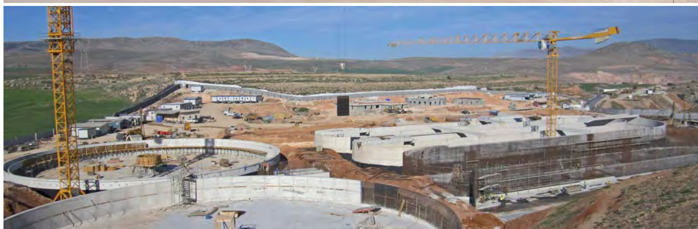
AGA - Instalación y equipo de explotación de la autopista Este-Oeste Argelia
