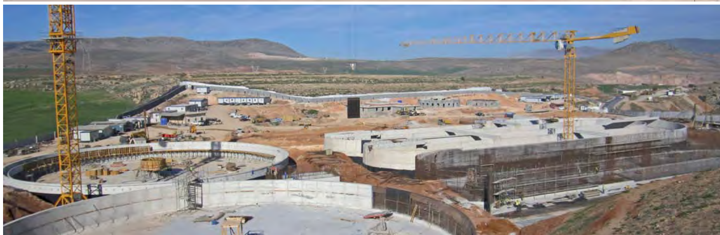
AGA - Installation et équipement d'exploitation de l'autoroute est-ouest Algérie
